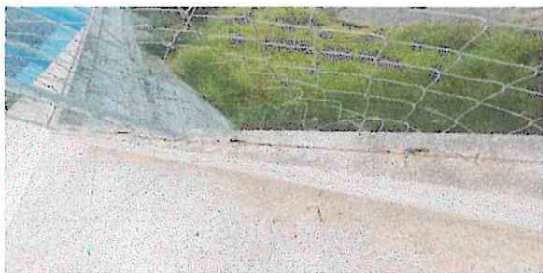
Foto 1: Muro y malla perimetral deteriorados, es necesario cambiarlos
