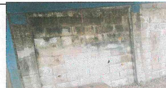
Foto 6: Deterioro de pared falta de pintura
