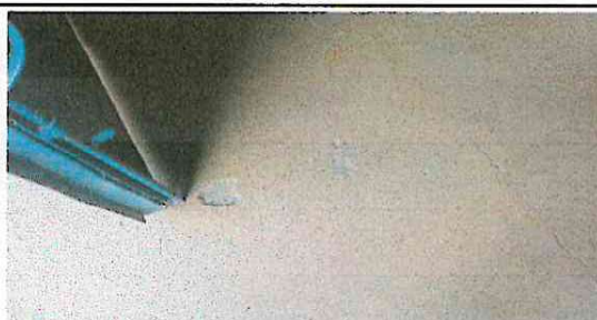
Foto 6: Deterioro, piso en mal estado
