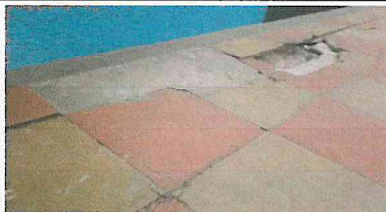
Foto 4: Deterioro en piso, sustitución
