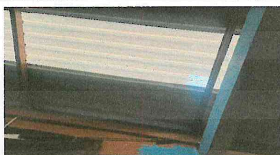
Foto 2: Orificios en láminas, como resultado ingreso de lluvias
