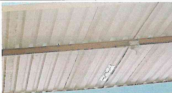
Foto1: Ingreso de lluvia, viento y sol por lamina en mal estado, es necesarios sustituirlas
