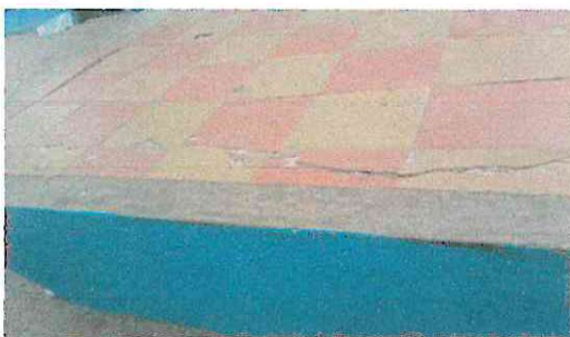
Foto 3: Deterioro de piso en escenario, es necesario sustituirlo
