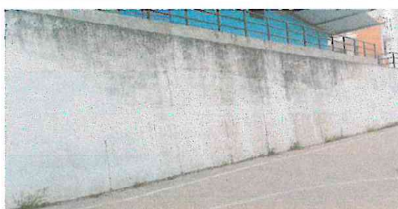
Foto 5: deterioro de pared, manchas, falta de pintura
